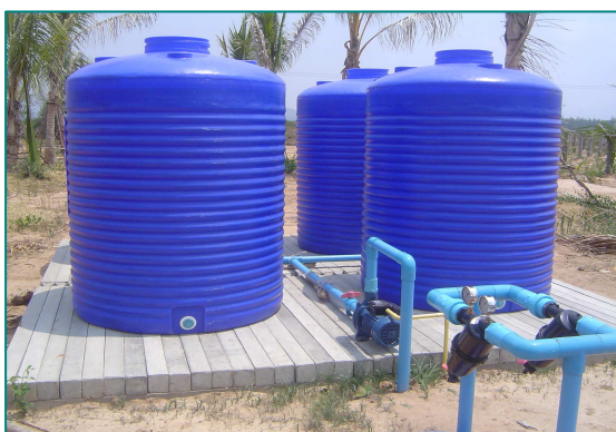
ระบบน้ำพร้อมถังพัก
